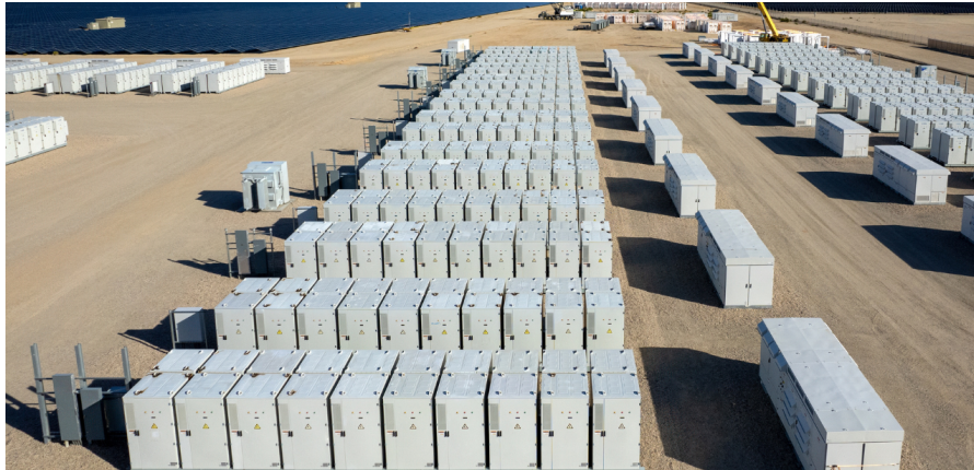
Site gigantesque de stockage électrique dans la Maine (USA), couplé à un parc solaire
